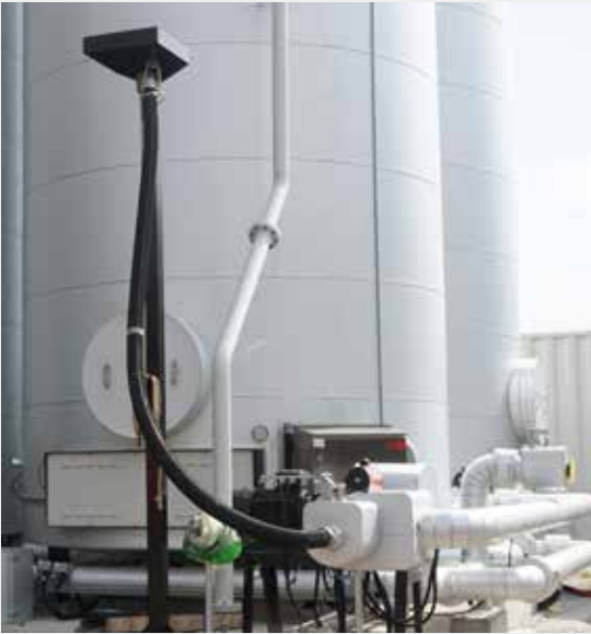
Central fyldepumpe type HD8 og manifold med ventiler
