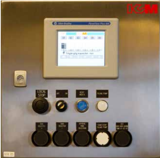
Fyldepumpen har sin egen fyldestyring i form af et operatorpanel med HMI-display indbygget i et kabinet af rustfrit stål.
